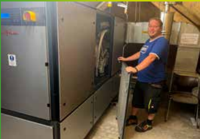
Patrick Schindler von der Haustechnik zeigt das Blockheizkraftwerk (BHKW) im Gabriele-Münter-Haus auf dem Argonnenareal in Weingarten.
