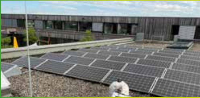
Die Photovoltaikanlage (PV) auf dem Dach des Kinderhauses Wirbelwind in Weingarten.
